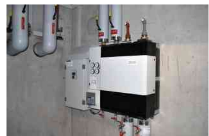
Übergabestation: Die Nahwärme hat auf kleinstem Raum Platz. Die sechs Gebäude werden über das gasbetriebene WKK-Nahwärmenetz der Gruppe E beheizt.
