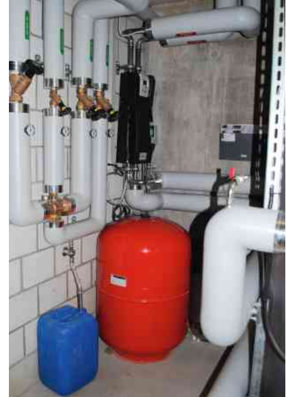
Mischanlage mit Thermomischer an der Wand: Hier wird dem auf bis 90 °C solar aufgeheizten Warmwasser Kaltwasser beigemischt, sodass es in den Verteilungen 60 °C warm ist.
