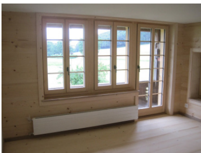
Umbau Bauernhaus, Pierrafortscha Wärmeverteilung mit Heizkörpern
