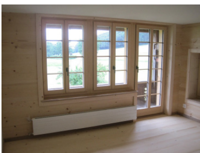
Umbau Bauernhaus, Pierrafortscha Wärmeverteilung mit Heizkörpern
