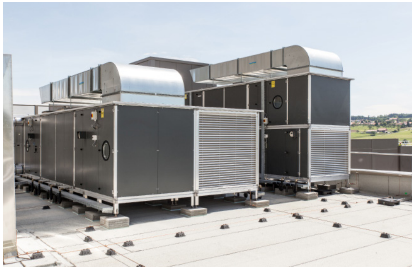
Nespresso PC3, Romont Monoblock über Dach
