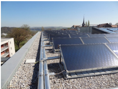
Home médicalisé Böisingen Système solaire thermique comme chauffage d'appoint et production d'eau chaude sanitaire
