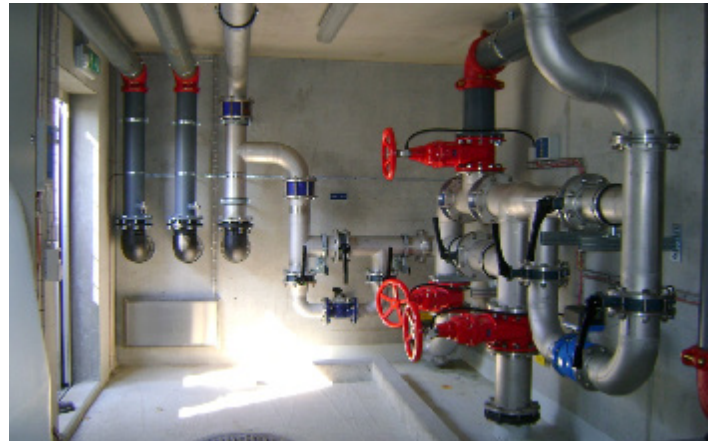
Micarna SA, Courtepin Distributeur inox soudé pour système de détection incendie (Sprinkler)
