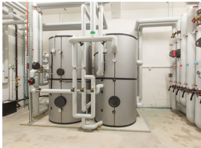
Rue François-d'Alt (Gainerie), Fribourg Zentrale Brauchwarmwasser-Produktion
