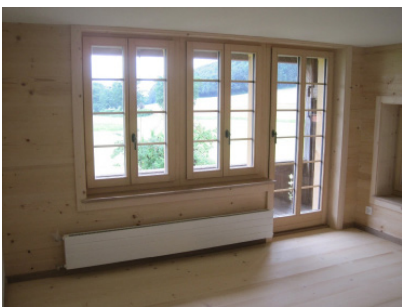
Umbau Bauernhaus, Pierrafortscha Wärmeverteilung mit Heizkörpern
