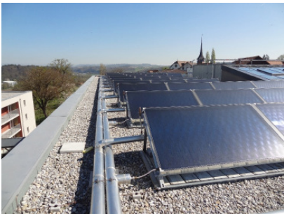
Pflegeheim Böisingen Solare Kollektorenanlage zur Heizungsunterstützung und Brauchwarmwasser-Produktion
