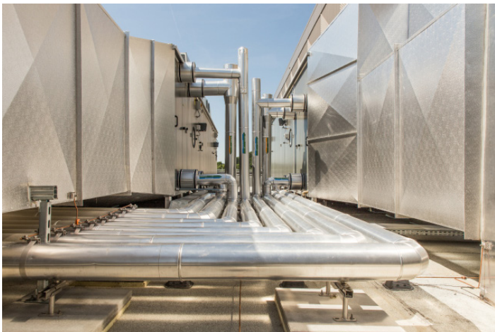
Nespresso SA, Romont Installations de chauffage et froid, ainsi que ventilation, monoblocs sur toiture
