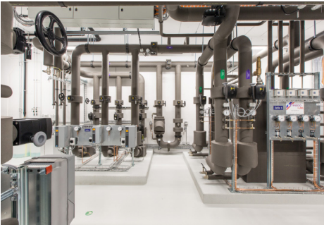
Swisscom Rechenzentrum XDC, Bern Heizung und Kälteanlage
