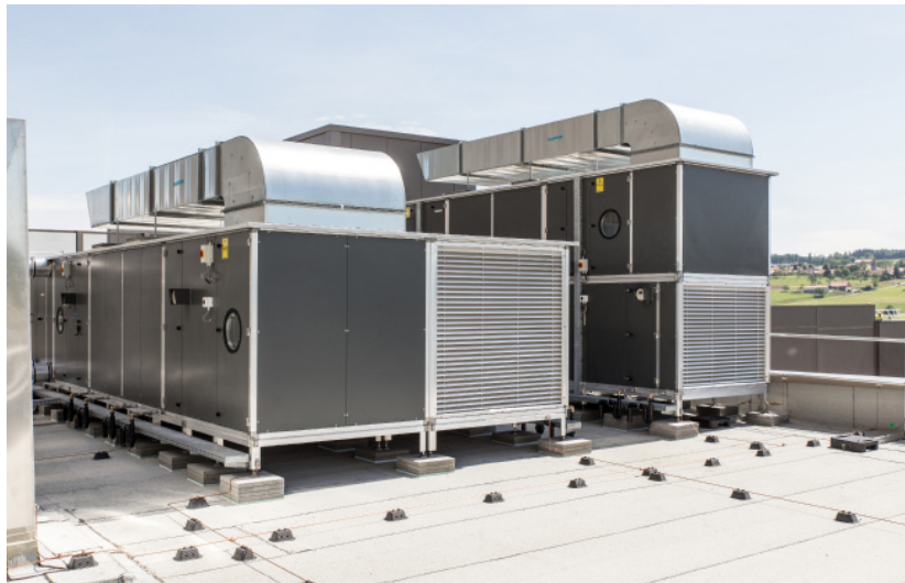
Nespresso PC3, Romont Monoblock über Dach
