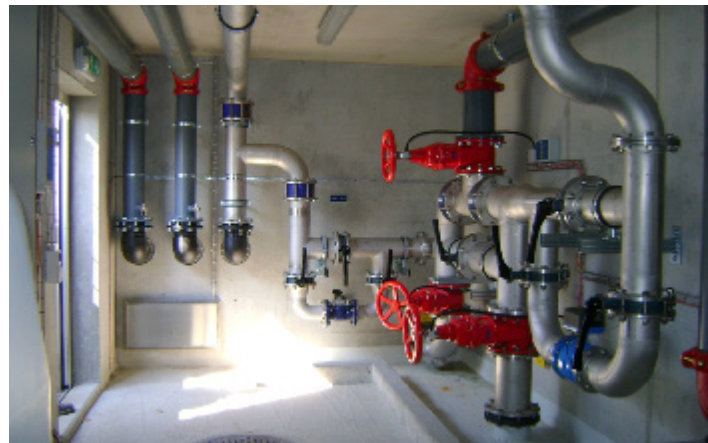
Micarna, Courtepin Geschweisster Inox-Verteiler für Brandschutzanlage (Sprinkler)
