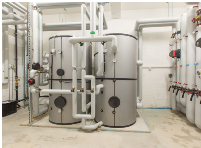
Rue François-d'Alt (Gainerie), Fribourg Zentrale Brauchwarmwasser-Produktion
