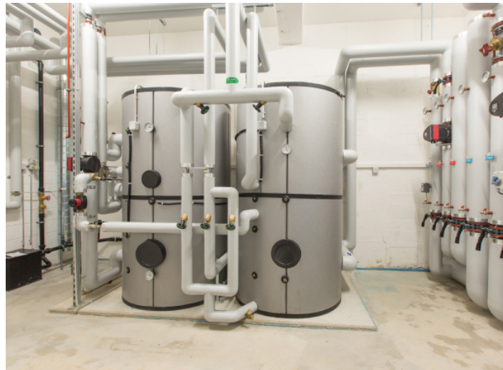
Rue François-d'Alt (Gainerie), Fribourg Zentrale Brauchwarmwasser-Produktion
