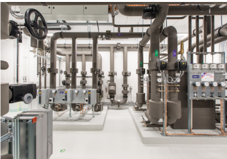
Swisscom Rechenzentrum XDC, Bern Heizung und Kälteanlage
