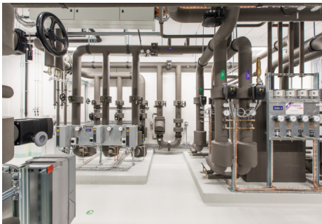
Swisscom centre de calcul XDC, Berne Installation de chauffage et de froid
