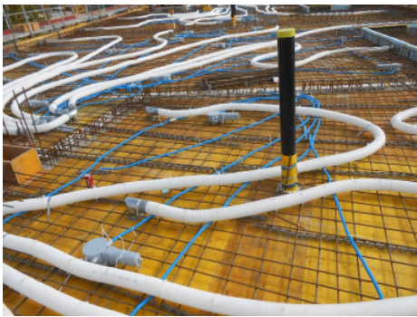
AGY-Parc, Granges-Paccot Éléments en dalle pour une ventilation contrôlée
