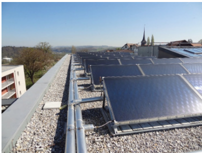
Pflegeheim Bösinggen Solare Kollektorenanlage zur Heizungsunterstützung und Brauchwarmwasser-Produktion
