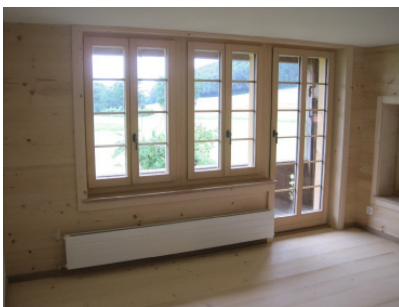
Umbau Bauernhaus, Pierrafortscha Wärmeverteilung mit Heizkörpern
