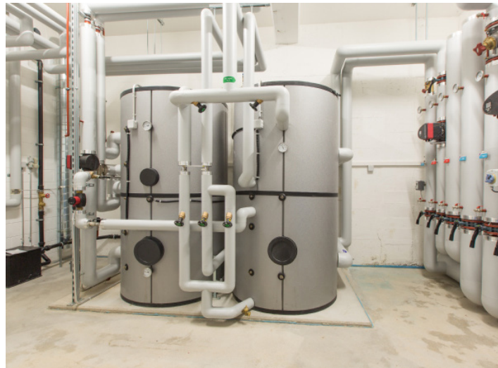
Rue François-d'Alt (Gainerie), Fribourg Production d'eau chaude sanitaire centralisée
