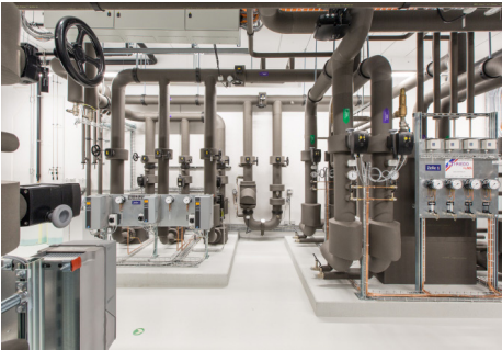
Swisscom centre de calcul XDC, Berne Installation de chauffage et de froid
