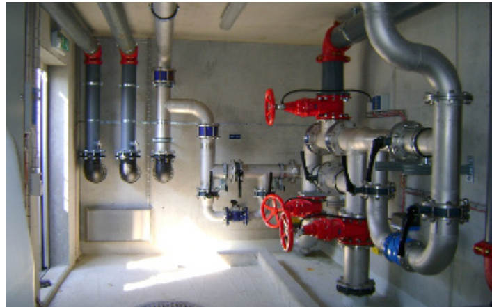
Micarna SA, Courtepin Distributeur inox soudé pour système de détection incendie (Sprinkler)
